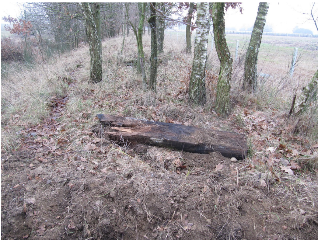
Zdj. 11. Nasyp ziemny pod trasa kolei wąskotorowej. Widoczne pozostałości z podkładów kolejowych.
