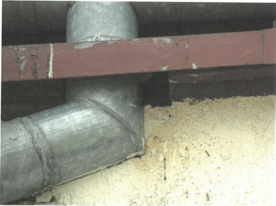
Fot. 3 Nisza lęgowa wróbla pod opierzeniem blacharskim ściany frontowej.
