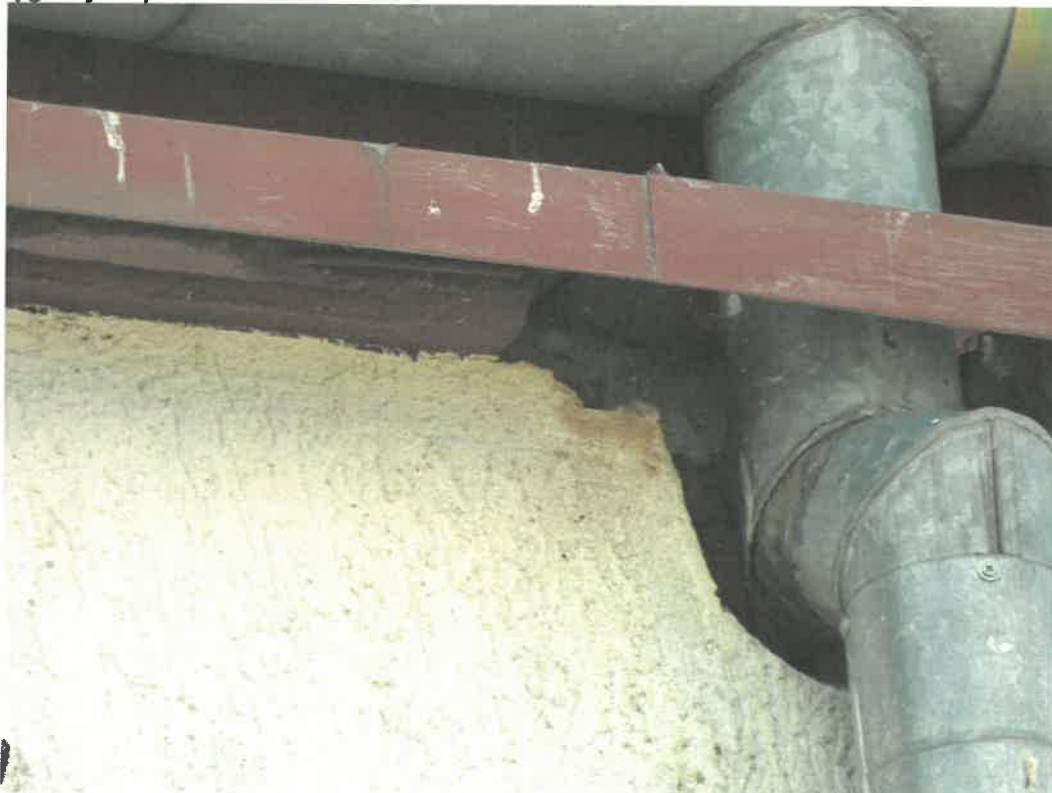
Fot.2 Nisza lęgowa wróbla pod opierzeniem blacharskim ściany frontowej.
