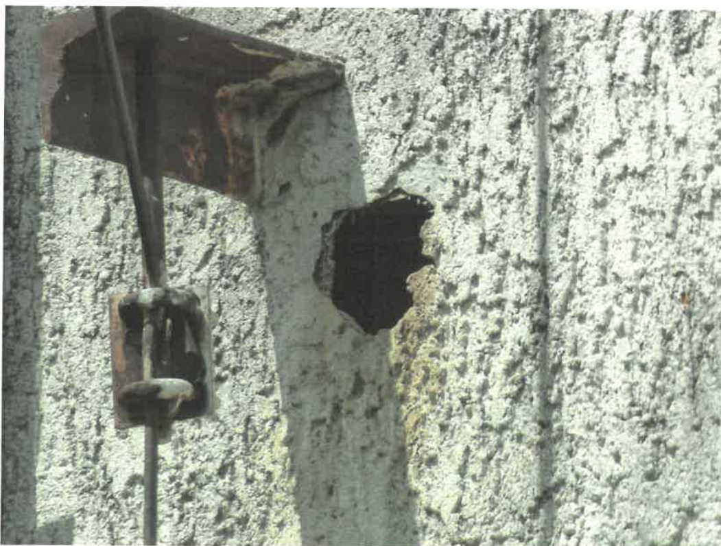
Fot. 7 Nisza lęgowa wróbla w ubytku elewacji ściany tylnej.
