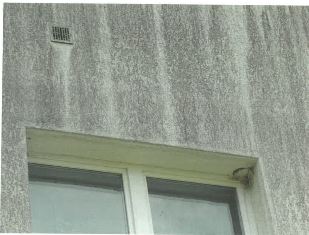
Fot.16 Ślady po gniazdowaniu oknówek w narożnikach okien.
