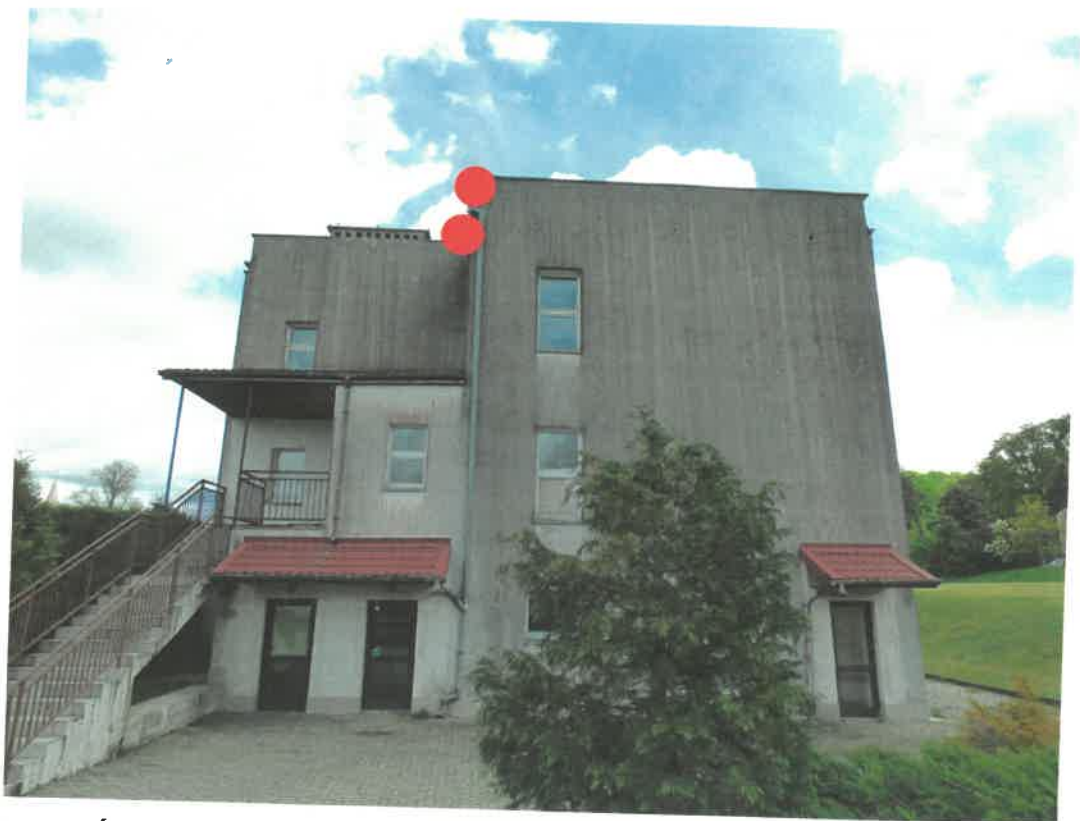
Fot.14 Ściana boczna (zachodnia) z zaznaczonymi niszami lęgowymi ptaków.
