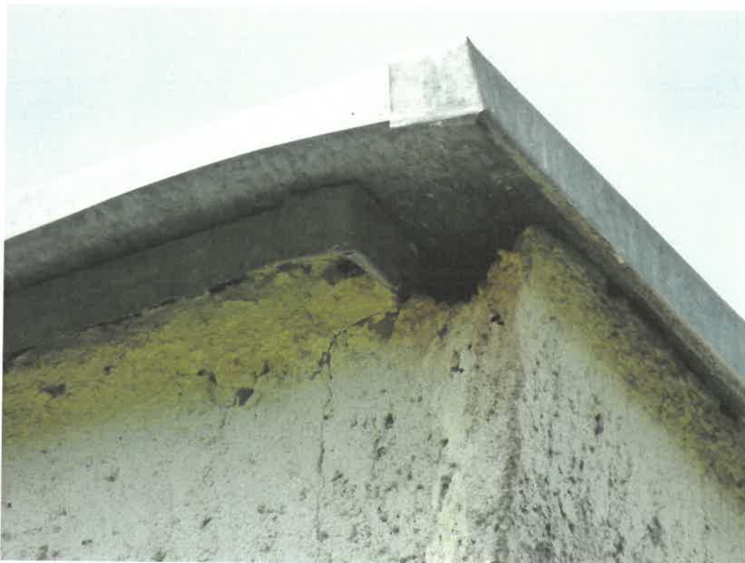
Fot.9 Nisza lęgowa wróbla pod opierzeniem blacharskim w ścianie tylnej.
